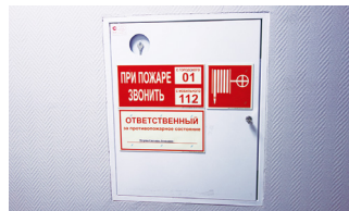
オフィス内に設置された消火設備
